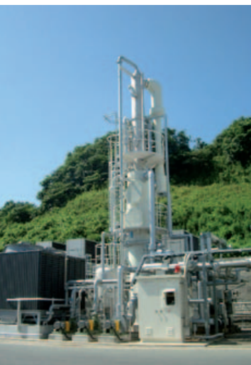
Ohmu Milk 2003 (Japon) Installation de refroidissement sous vide 313 kW
